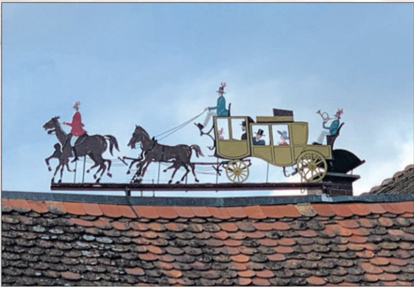
Die Dachreiter erstrahlen in neuem Glanz und verleihen damit dem Rettershof noch mehr Glanz. Dank einer großzügigen Spende der Bürgerstiftung konnte das Projekt umgesetzt werden. Foto: Judith Ulbricht
