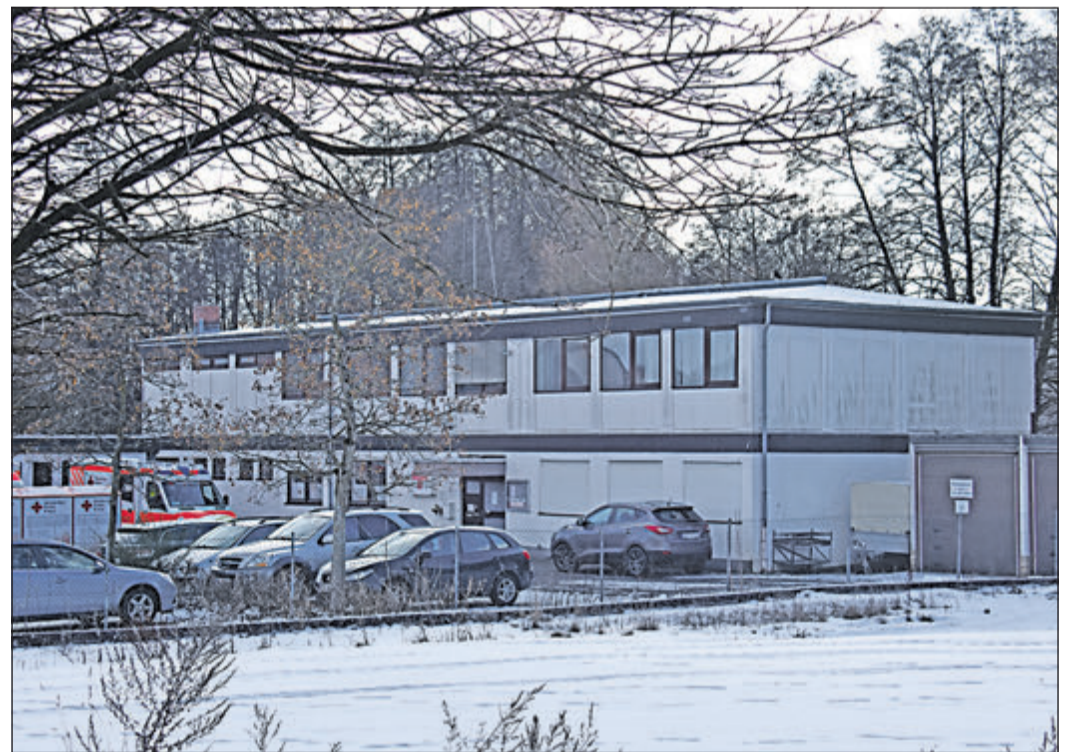
Eine Sanierung des DRK-Gebäudes steht angesichts des geplanten Katastrophenschutzentrums nicht mehr zur Diskussion. Dennoch muss das nicht mehr vollkommen standsichere Obergeschoss abgesichert werden. Voraussichtliche Kosten: 40 000 Euro. Foto: ach
