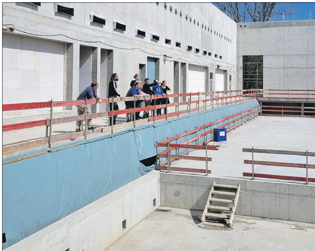
Noch fehlt das Dach auf der neuen Schwimmhalle am Wiesenbad. Generalplaner Eshref Bajrami führte Vertreter der Eschborner Schwimmvereine über die Baustelle. Foto: Stadt Eschborn
