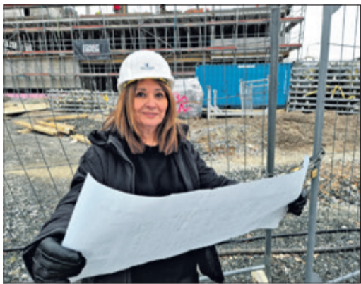
Projektleiterin Corina Kaiser, Abteilung Gebäude und Liegenschaften, beaufsichtigt die Bauarbeiten an der neuen Feuerwache. Foto: Stadt Bad Soden
