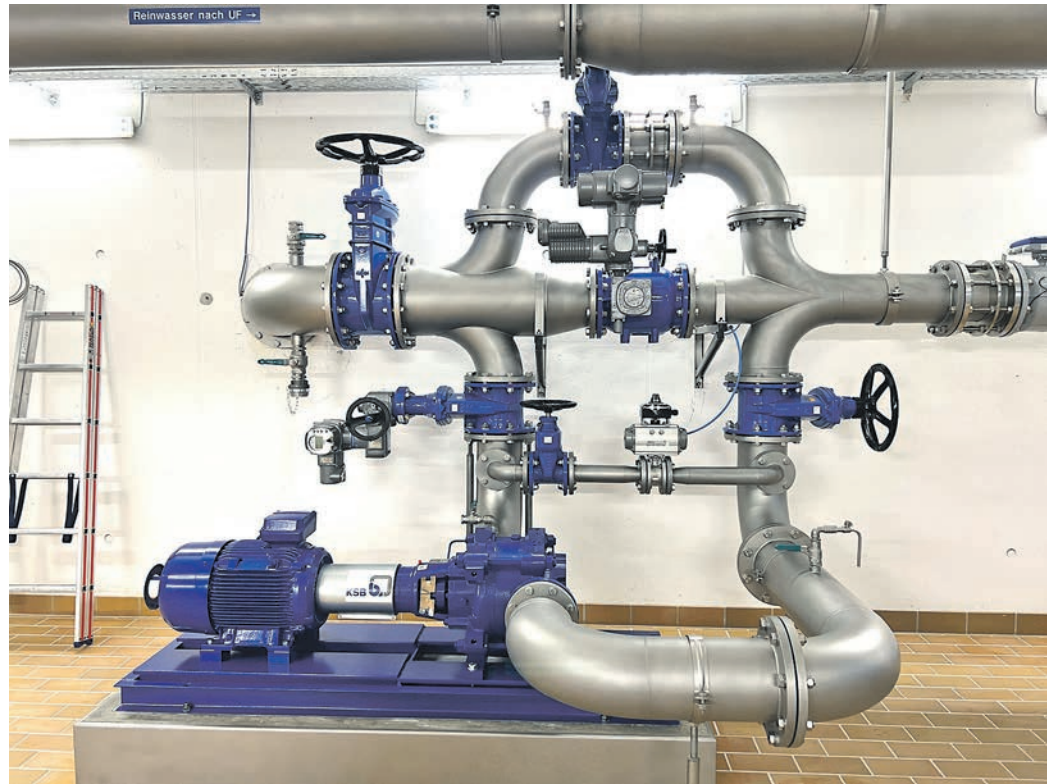
Seit Juni produziert die Stromgewinnungsanlage in der Wasseraufbereitungsanlage Hohemark (WA Hohemark) etwa 20 Prozent des gesamten Strombedarfs der Gewinnungsanlagen im Haidtränktal und der WA Hohemark selbst. Foto: Stadtwerke Oberursel
