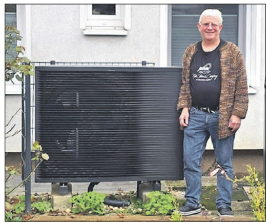
Arbeitskreis-Mitglied Jörn Broda vor dem Ventilator seiner Wärmepumpe. Foto: privat
