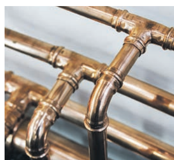
Edles Metall mit vielen guten Eigenschaften: Wer seine Hausinstallation mit Kupfer plant, setzt auf Langlebigkeit und Investitionssicherheit.
