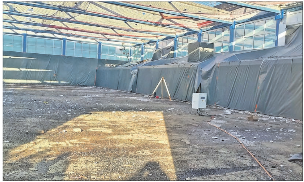
Blick in die Halle 1 der Doppelhalle EKS vom hinteren Parkplatz aus. Man sieht den abgedeckten Tribünenkomplex (rechts), durch die offene Hallendecke fällt Licht und Regen, Pfützen zieren die abgetragene Bodenfläche. Foto: js
