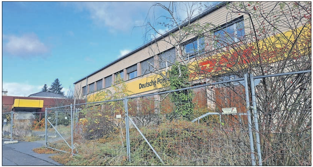
Dem Gelände mit dem alten Postgebäude ist anzusehen, dass es seit mehreren Jahren nicht genutzt wird. Foto: gt
