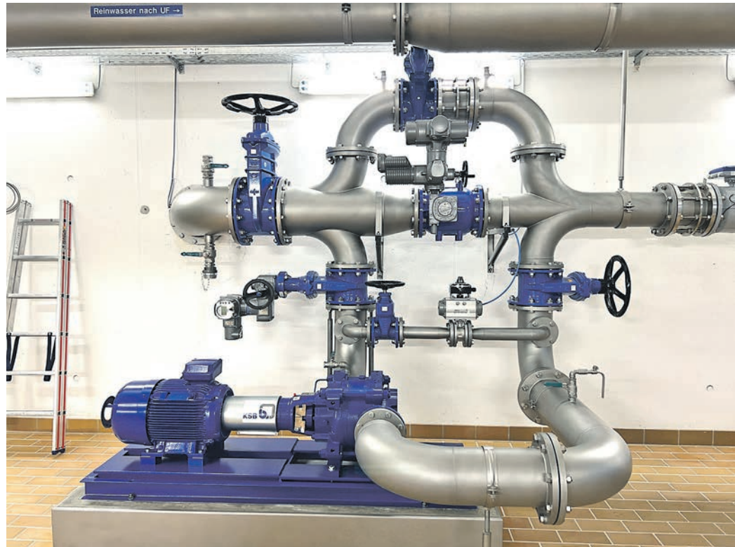
Seit Juni produziert die Stromgewinnungsanlage in der Wasseraufbereitungsanlage Hohemark (WA Hohemark) etwa 20 Prozent des gesamten Strombedarfs der Gewinnungsanlagen im Haidtränktal und der WA Hohemark selbst. Foto: Stadtwerke Oberursel
