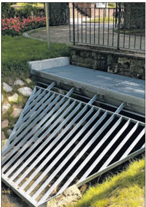
Neue Rechenanlage im Quellenpark
