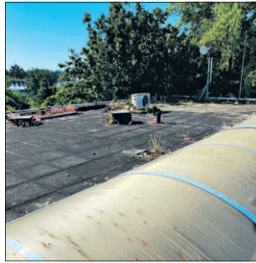
Das Dach des Wasserwerks in der Sulzbacher Straße muss dringend saniert werden.
