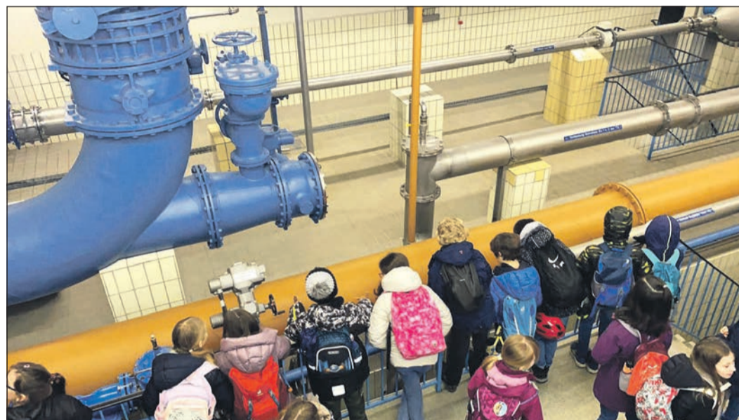
Schüler der Burgwiesenschule blicken bei der Führung durch den Hochbehälter Borkenberg in den beeindruckenden Rohrkeller. Foto: Jakob Weishaupt
