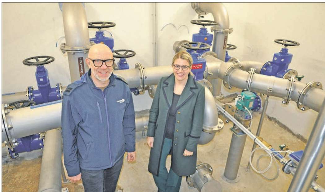
Stadtwerke-Geschäftsführerin Julia Antoni und Dieter Gredig, Leiter Netze Gas & Wasser bei den Stadtwerken freuen sich über den sanierten Hochbehälter 3, der bereits 1911 gebaut wurde und damit der älteste Behälter ist.. Foto: Königslehner
