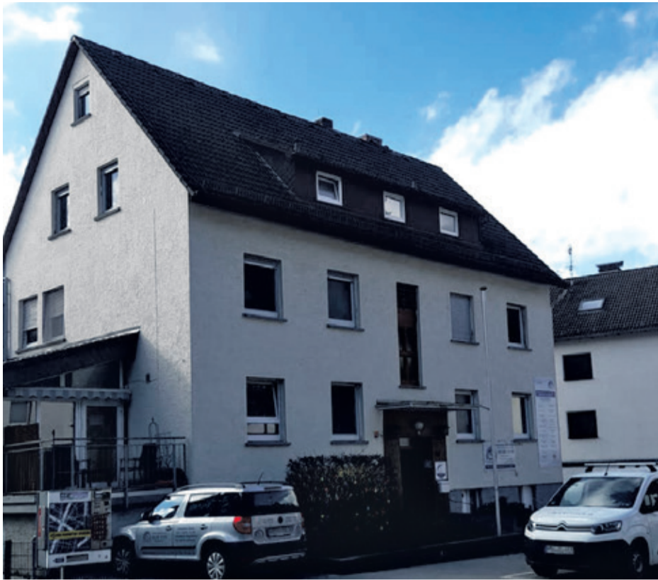
Das sanierungsbedürftige Gebäude in der Brunhildestraße in Schmittien. Vom Dach bis hinab in den Keller sind Investitionen nötig. Foto: privat
