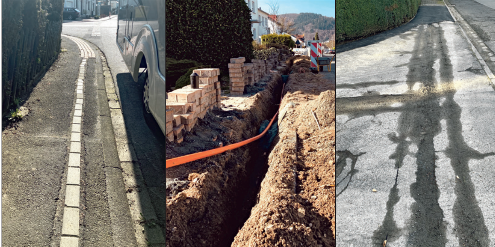
Die Sodener Straße in Fischbach ist ein „Paradebeispiel“ für die Arbeit der Subunternehmer. Inzwischen wurde sie an bestimmten Stellen schon fünf Mal geöffnet und dann provisorisch wieder verschlossen. Mal mit dem Herbstlaub-Pflasterstein, dann einfach mit Schotter oder einer Asphaltdecke – auch auf Gehwegen. Anwohner anderer Straßen berichten von wackelnden Gehwegplatten. Auch in den Vogelwegen in Hornau (Foto re.) wurde der Asphalt aufgefräst und dann mit Schotter verschlossen. Fotos: Judith Ulbricht
