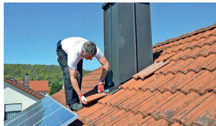
Anschlüsse an Dachdurchdringungen werden beim DachCheck begutachtet. Foto: HF Redaktion/akz-o
