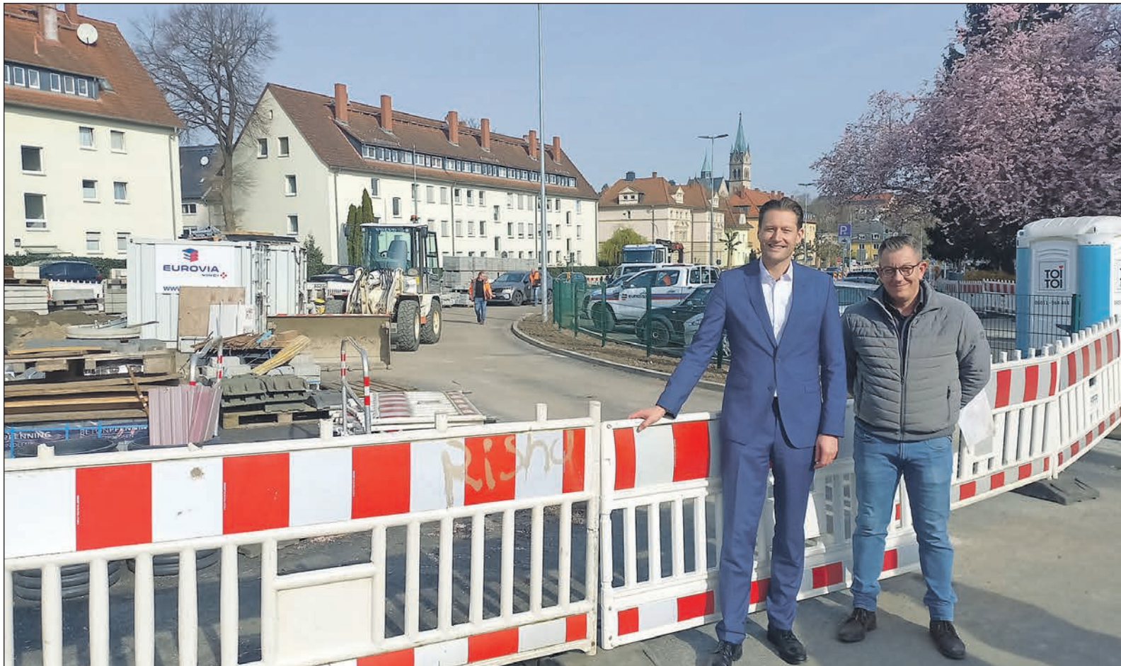
Lagebesprechung am Dreieck Schleußnerstraße, Frölingstraße und Verlängerung zum Bahnhof: Oberbürgermeister Alexander Hetjes (l.) und Martin Schmitt vom Fachbereich Tiefbau begutachten den Stand der Dinge an der Dauerbaustelle im Zusammenhang mit der Entwicklung des Vickers-Areals. Im Hintergrund ist der Turm der Kirche St. Marien zu sehen. Foto: js
