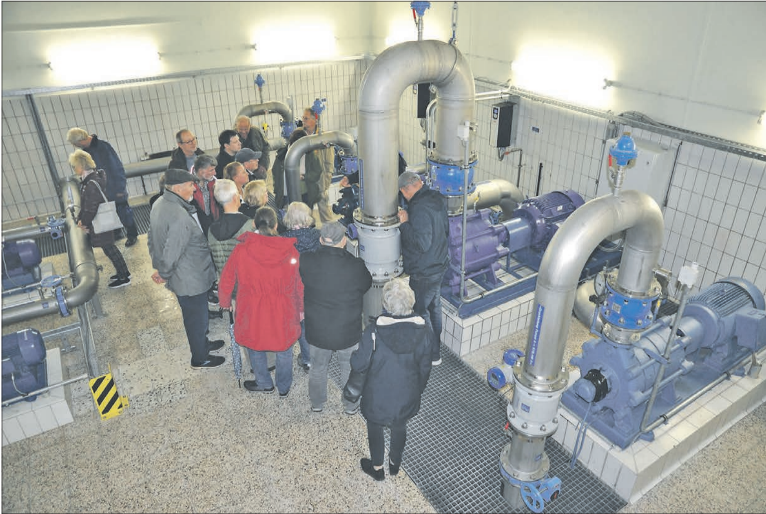
Tief beeindruckt und interessiert zeigen sich die Besucher an der Technik zur Wasseraufbereitung im Pumpwerk.
