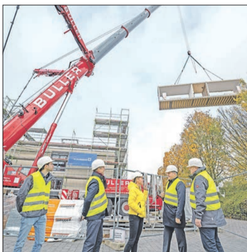
Bei der Begutachtung der Baustelle mit Landrat Ulrich Krebs (2. v. r.) schwebt ein weiteres Modulteil für den Neubau der Erich-Kästner-Schule ein. Foto: Hochtaunuskreis
